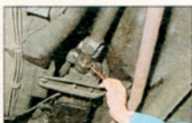
Ölverlust am Getriebehals: Die Simmering-Ringe am Kardanwellenantrieb verlieren ihre Dichtwirkung und müssen erneuert werden. Kosten: 100 Mark
